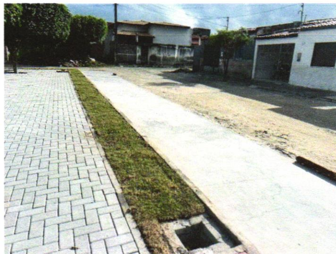
Foto 01 – PAVIMENTAÇÃO EM CONCRETO, COM ESPESSURA DE 7 CM, COM ACABAMENTO FEITO UTILIZANDO ALISADORA DE CONCRETO (HELICOPTERO), INCLUIDO TELA DE AÇO SOLDADA NERVURADA CA60, Q196 (3,11 KG/M2), DIAMETRO DO FIO 5.0 MM, LARGURA = 2,45 M, ESPAÇAMENTO DA MALHA = 10 X 10 CM, JUNTA DE DILATAÇÃO EM PVC A CADA 2,00 M, CONCRETO FCK = 20 MPA
